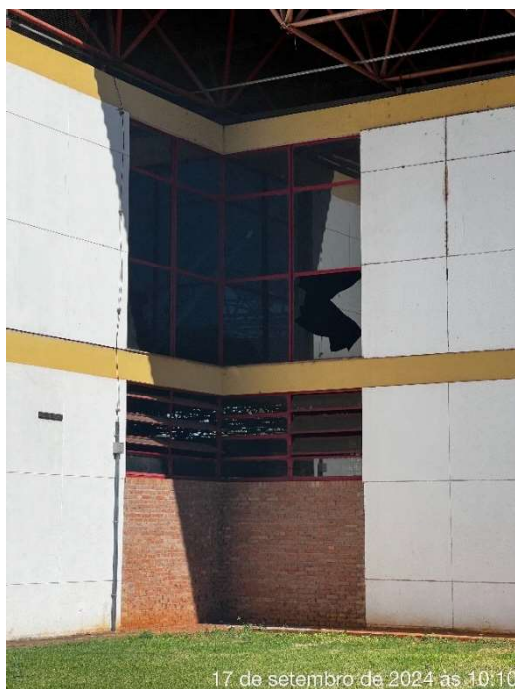
Figura 91: Vidros quebrados na fachada
