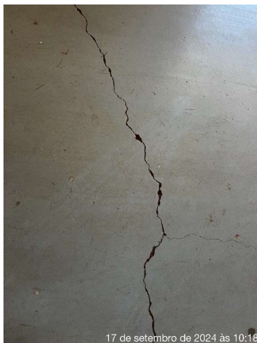
Figura 94: Rachadura de Piso - Pavilhão Cataratas
