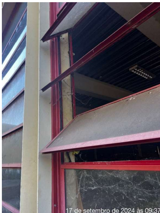
Figura 92: Sujeira nas esquadrias
