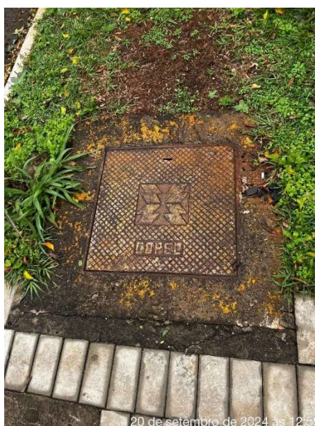
Figura 63: Caixa de Passagem Elétrica COPEL
