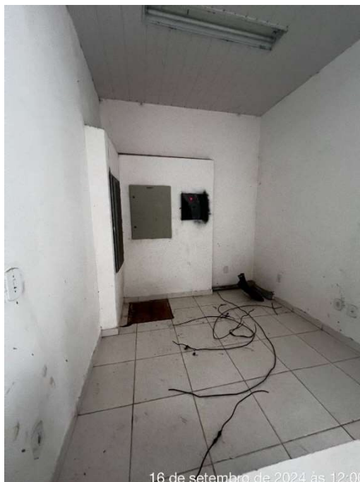
Figura 69: Central de Controle Poço Artesiano
