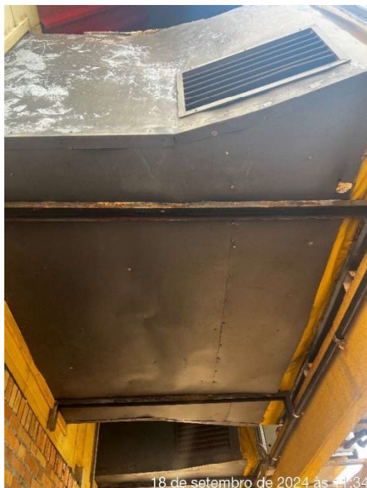
Figura 75: Duto de Ar
