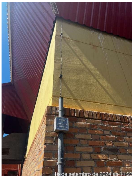
Figura 68: Resquícios instalação original SPDA
